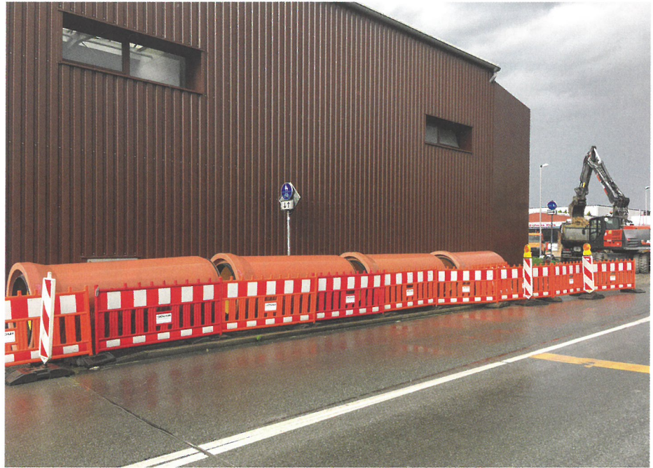
Im Umfeld der Baustelle stand wenig Platz zum Lagern der Rohre zur Verfügung.
