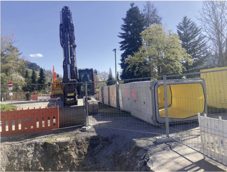
Für das Versetzen der 11,2 Tonnen schweren Rahmenprofile kam ein 60-Tonnen Bagger zum Einsatz. Das Verlegen des Systems mit Inliner und der Rohrverbindung mit einer speziellen Dichtung hat einwandfrei funktioniert.
